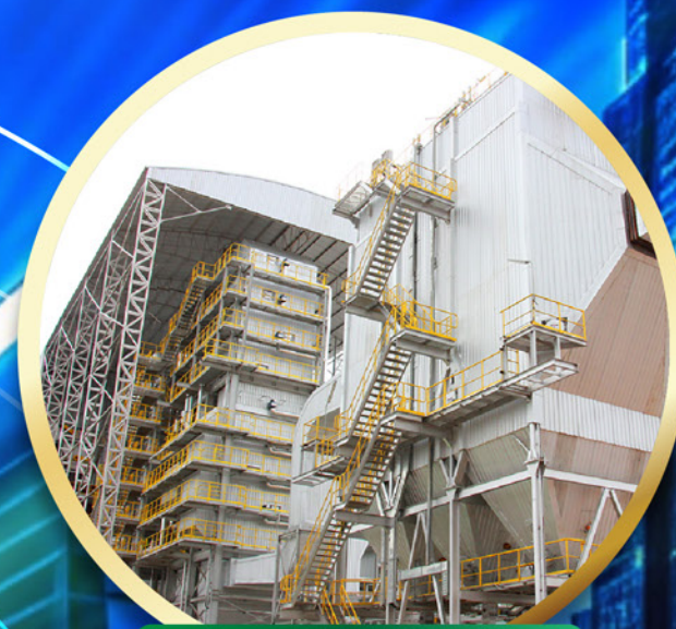
ธุรกิจโรงไฟฟ้า
